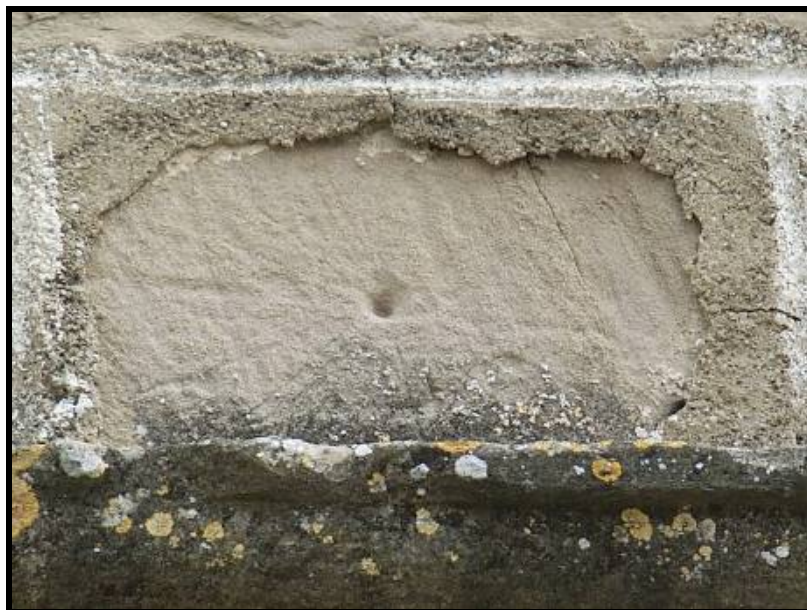
Radial en el centro del sillar. Muy deteriorado.
