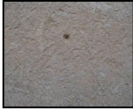
Reloj 2. Radial, erosionado.
