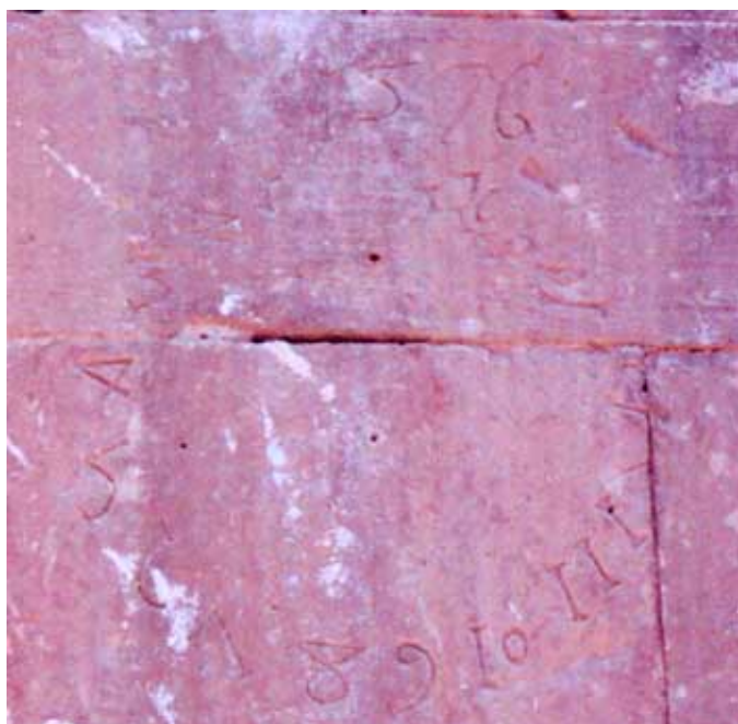
Grabación descubierta en la fachada sur dela iglesia.
