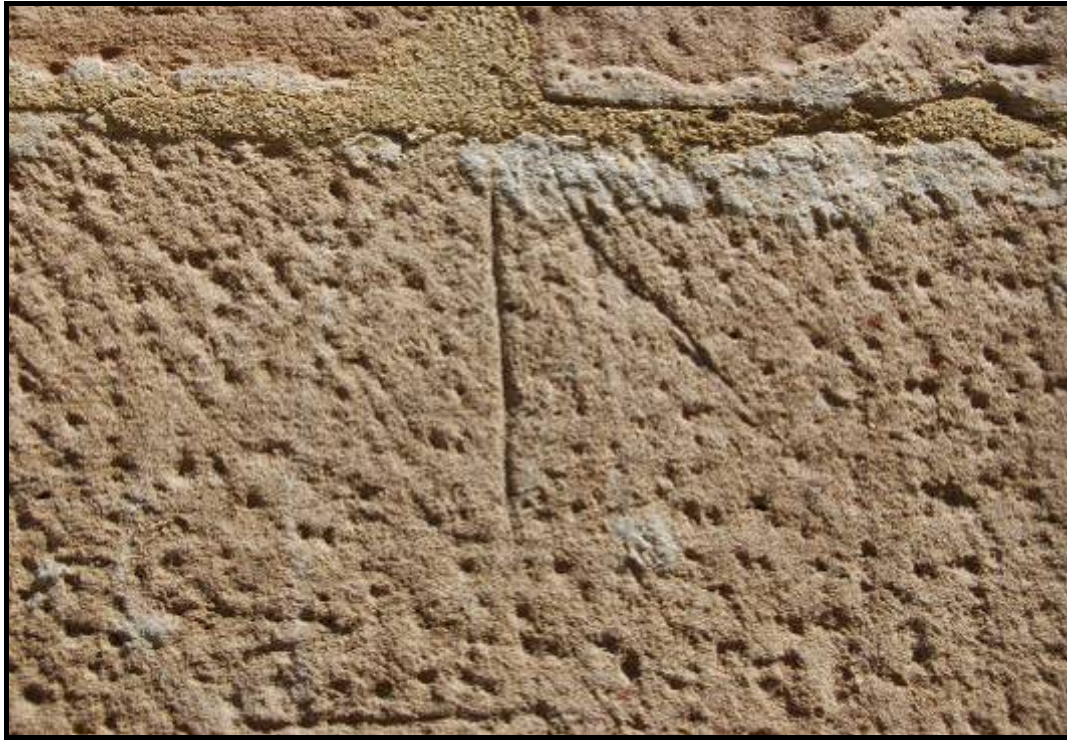
Reloj 1. Semicircular en junta de sillar, de 4 \times 45^\circ . Deteriorado.
